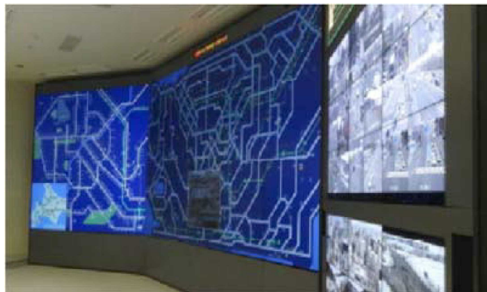
交通管制センター
