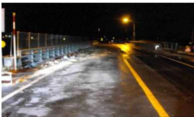
橋梁上の一部凍結
