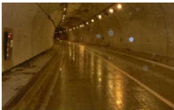
トンネル内の一部凍結
