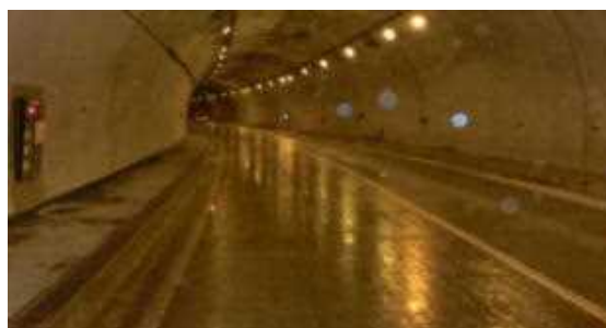
一部凍結したトンネル
