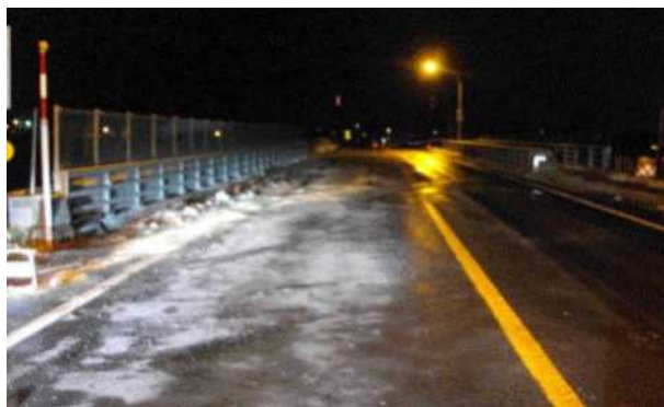
橋梁上の一部凍結路面
