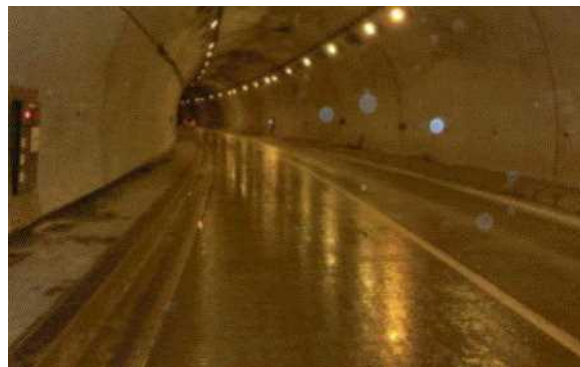
トンネル内の一部凍結路面
