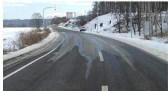
一部凍結した道路
